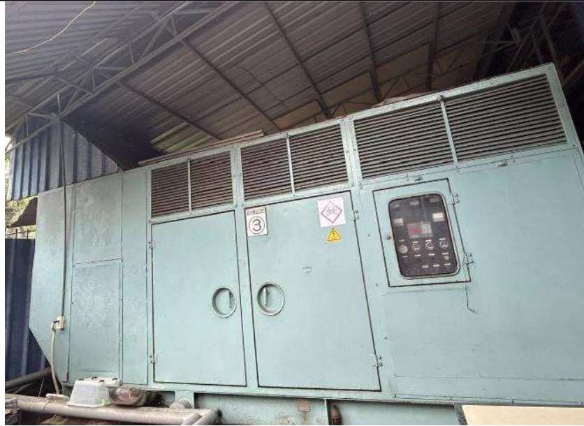
Hình 3.7. Máy phát điện tại cơ sở
